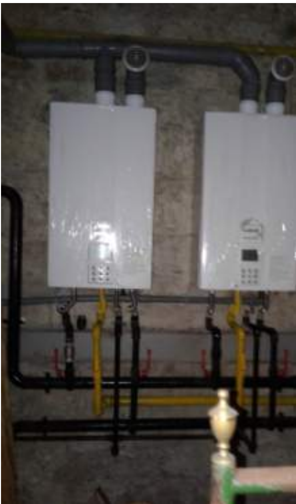
Le due caldaie murali da 35 kw del vecchio impianto
