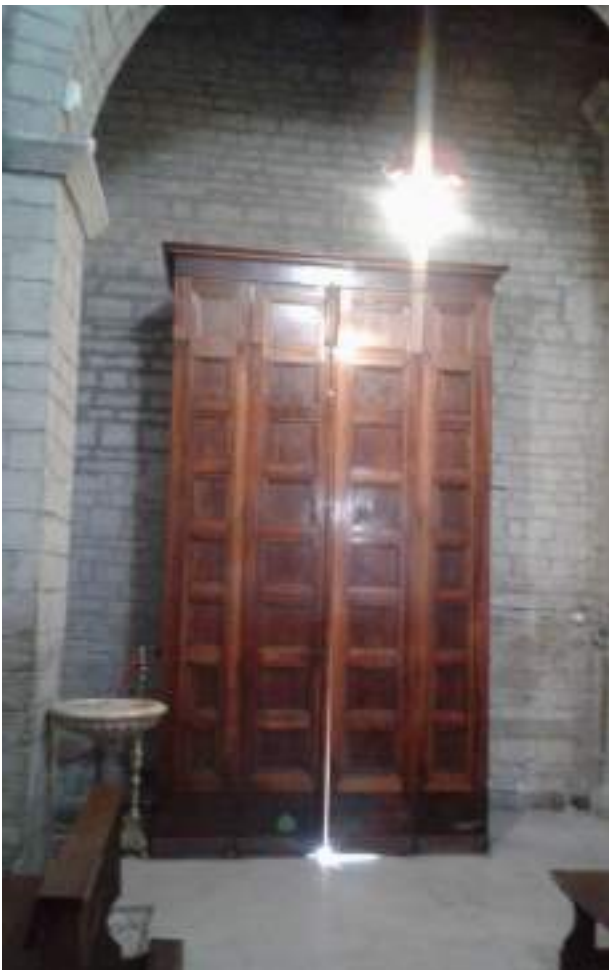
L'attuale bussola d'ingresso, già modificata negli anni '80 a seguito dell'abbassamento della quota pavimentale, ha le aperture verso l'interno e le ante dissestate
