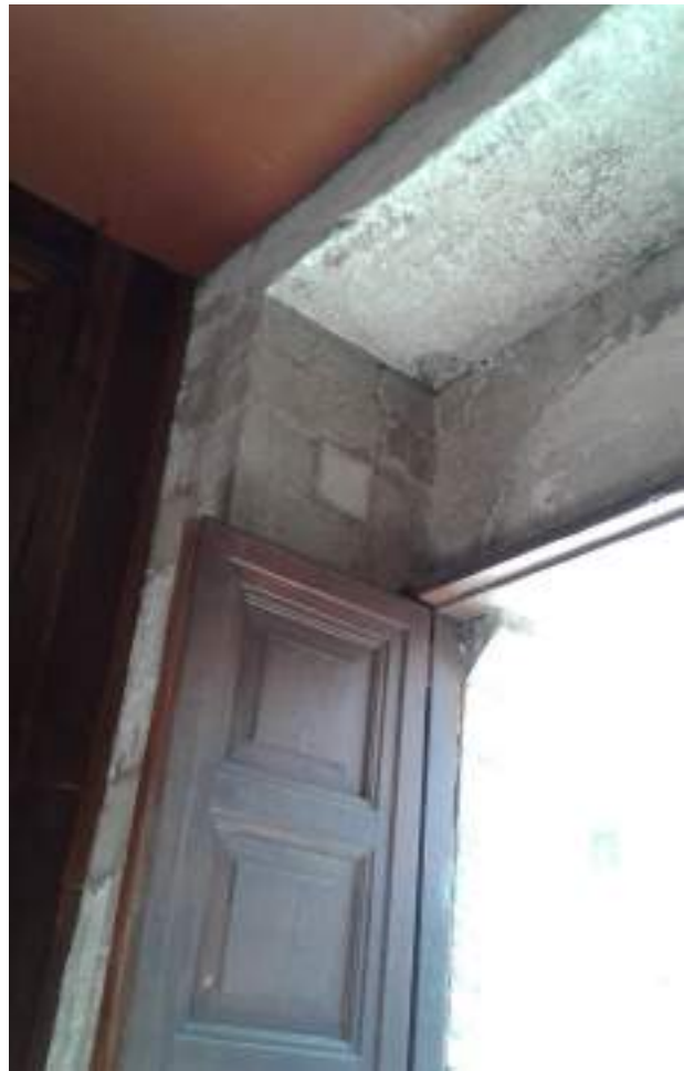
La porta dell'ingresso laterale e lo spazio vuoto esistente sotto la piattabanda
