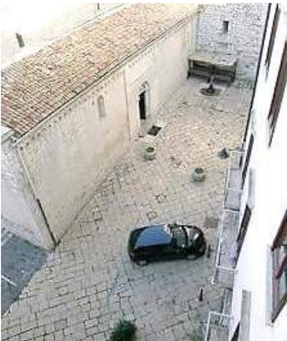
Il manto di copertura della navata laterale scompaginato
