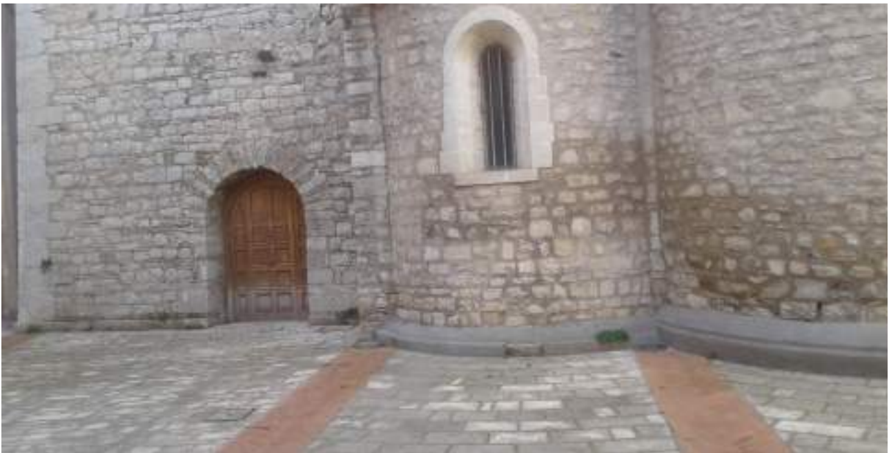
Il portone d'ingresso al campanile all'interno attuale locale caldaia dell'impianto di riscaldamento a pavimento della chiesa realizzato nei lavori di restauro degli anni '80.
