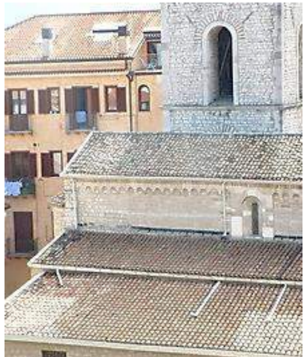
La copertura della navata centrale del tutto sconnessa
