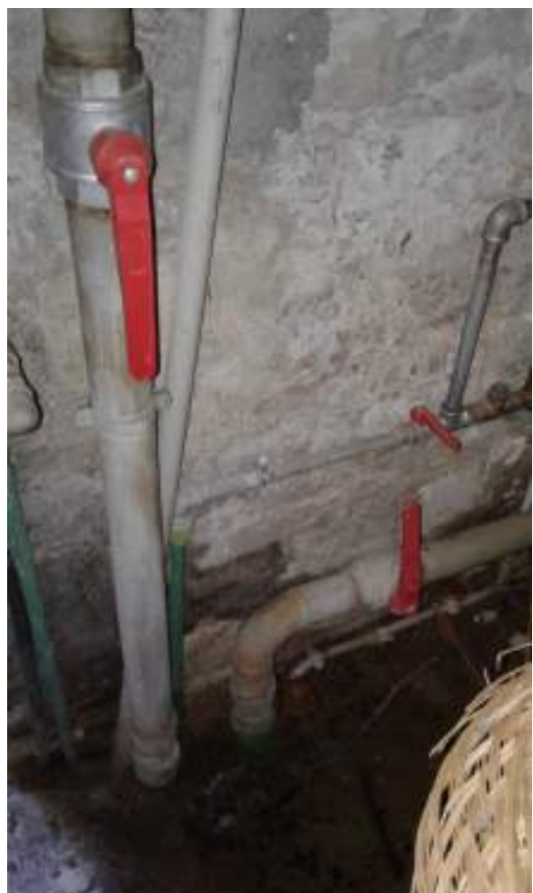
Le tubazioni di innesto (mandata e ritorno) all'impianto a pavimento della chiesa
